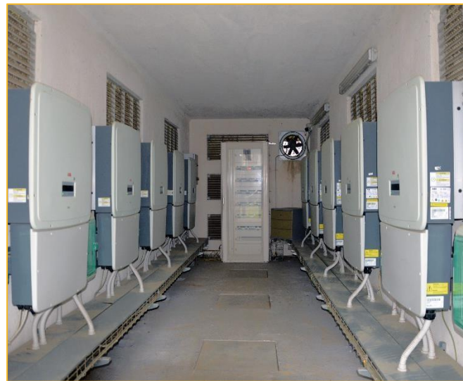
Fig. 3 – Sala de inversores.
